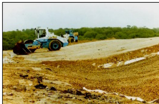
photo 8 : argile compactée pour l'étanchéité ; deux couches superposées de 50 cm, sur lesquelles on étalera 50 cm de terre végétale,
